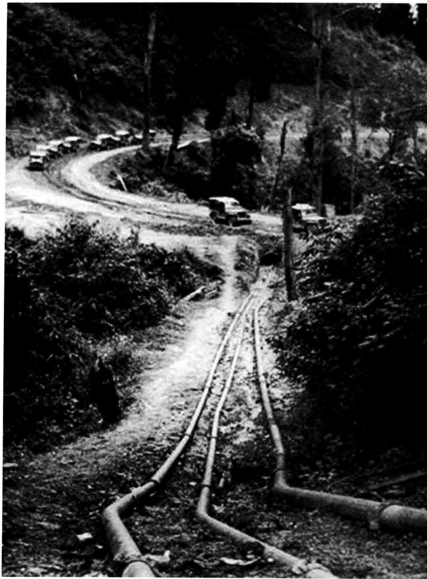
沿中印公路铺设的中印油管
